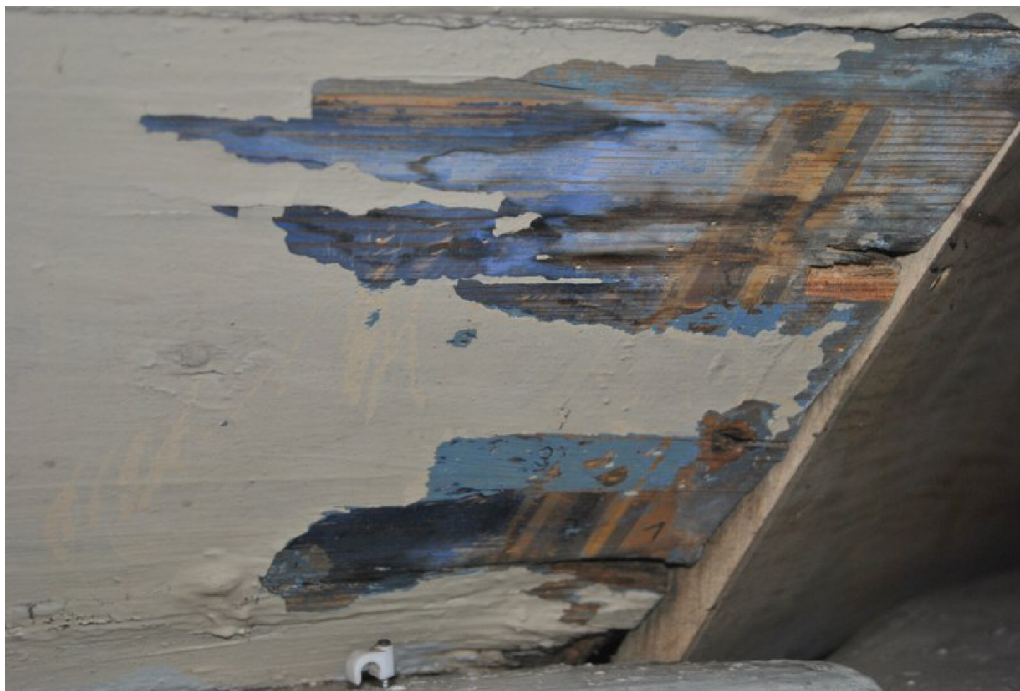
Fot. 4 Warstwa malarska na ścianach w kościele. Widoczne przemalowania oraz stan zachowania ścian kościoła.
